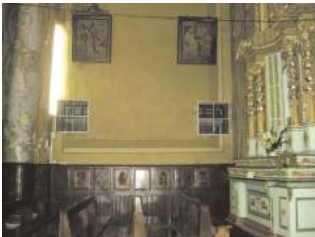
9. Interno chiesa, bocchette di uscita dell'impianto riscaldamento. (S. Migliorini)
