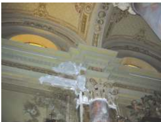
4. Interno della chiesa parrocchiale. Il degrado del capitello della parasta della navata sinistra. (M. Lévêque)
